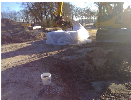
Foto 4 betondelen met asbest in big-bag als stortmateriaal
