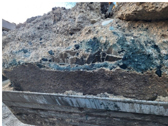
Foto 3 asbest in beton
