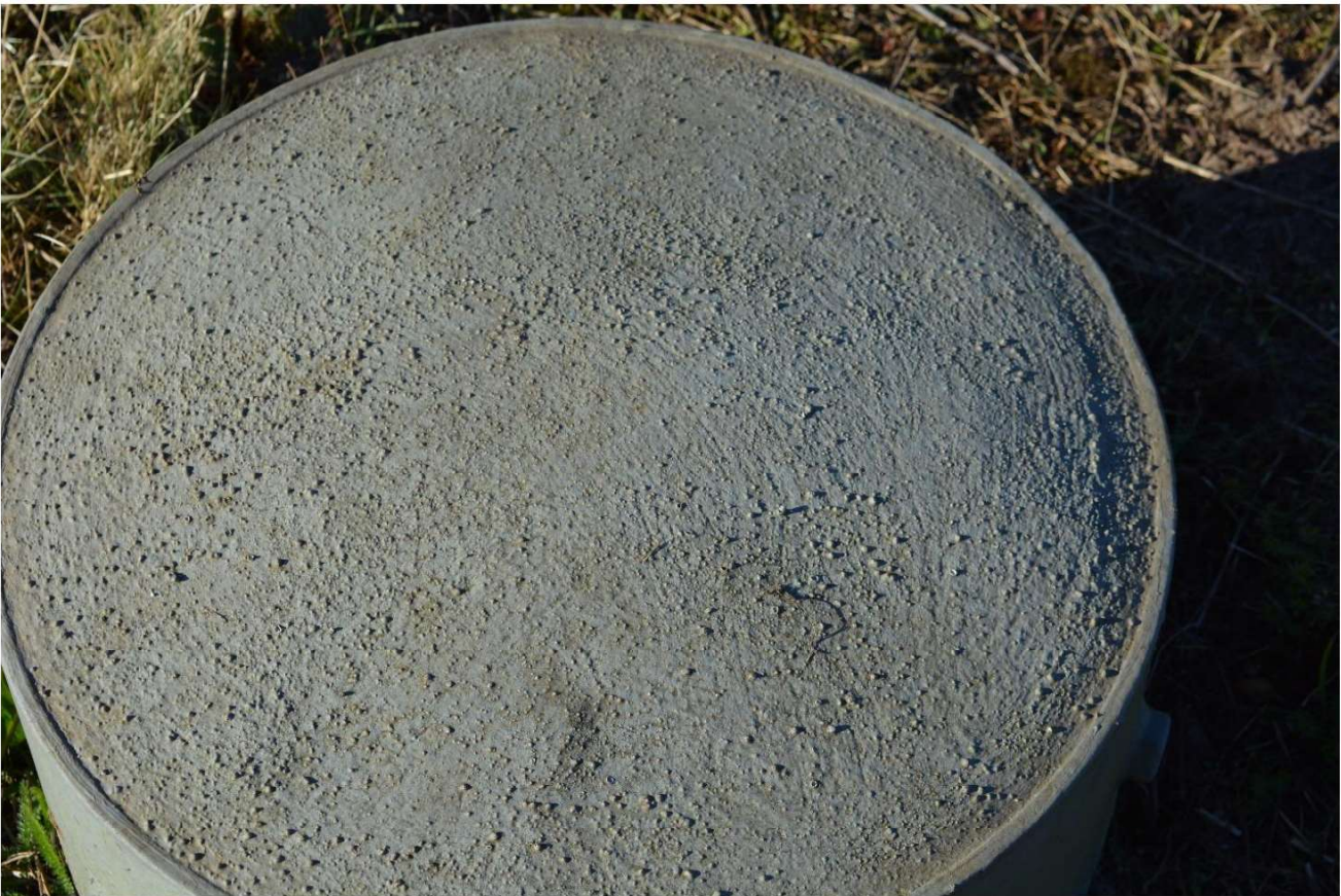
Figuur 3 Beton conditie
