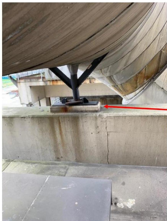
Spanning in leidingen door rotten en ingewaterde isolatie ( gewicht verzwaaard)
