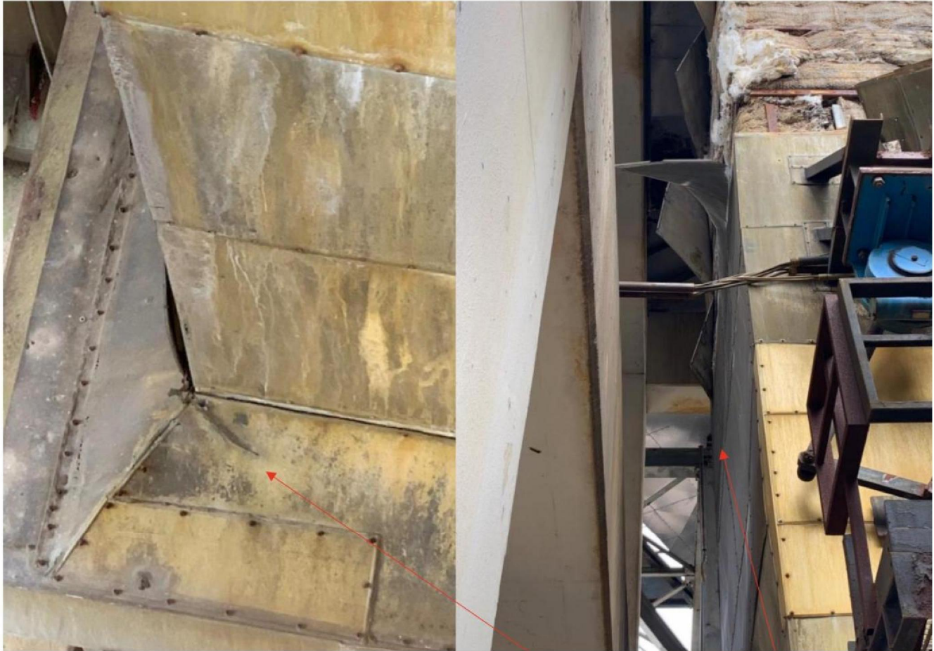
Losse en ingewaterde isolatie/ beplating
