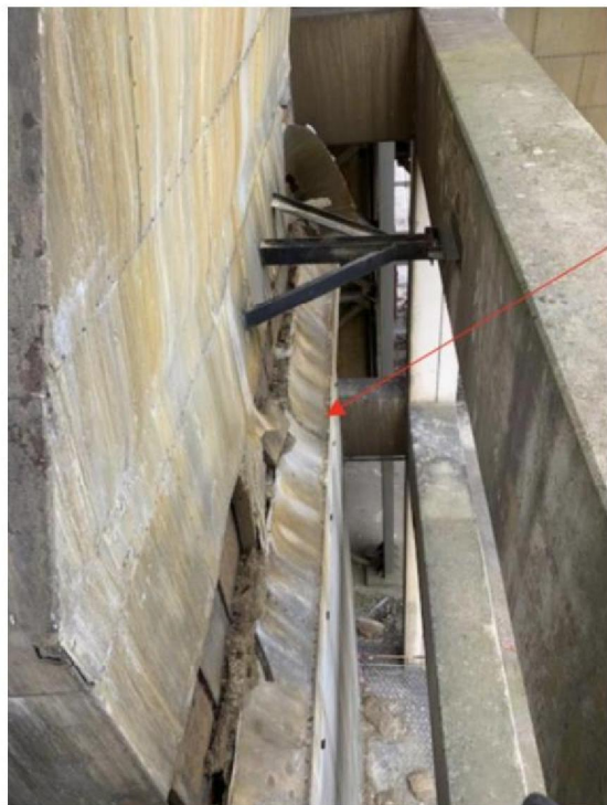
Losse beplating en constructie steunen
