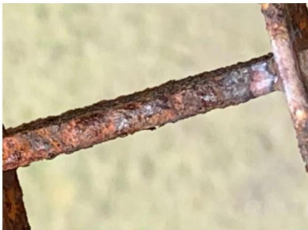
Constructie/ oplegging roosters aangetast.
