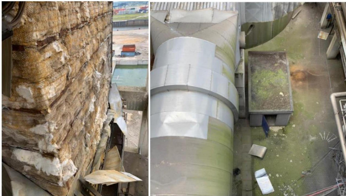
Beplating aangetast/ losgekomen/ gevallen.
