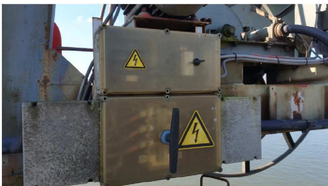
Fb03: Elektrische installatie/ zekeringen asbestverdacht. Betreft een (op)gesloten constructie.
