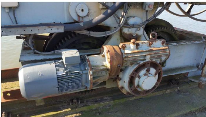
Fb02: Aandrijving/ remsysteem is asbestverdacht. Betreft een (op)gesloten constructie, asbest niet visueel waarneembaar.
