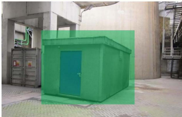
Z6L05.1: schakelgebouw Elektrofilter NW20
