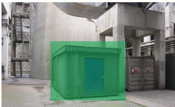
Z6L04.1: schakelgebouw Elektrofilter NW10
