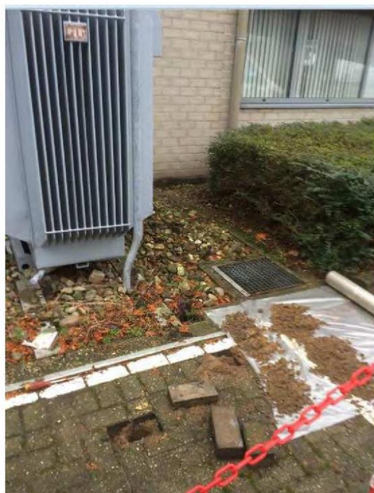
11 Olieopslag , buiten bij afdak
