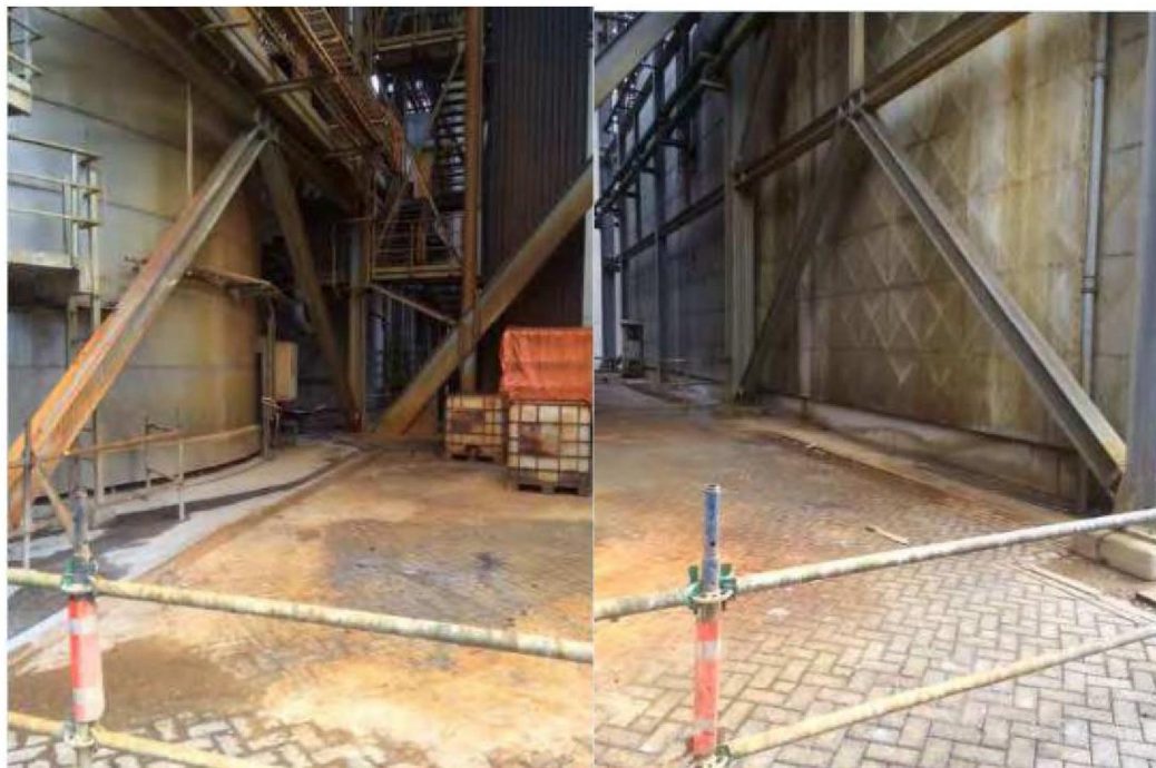
Situatie deellocatie 14, lekkend zuur waswater
