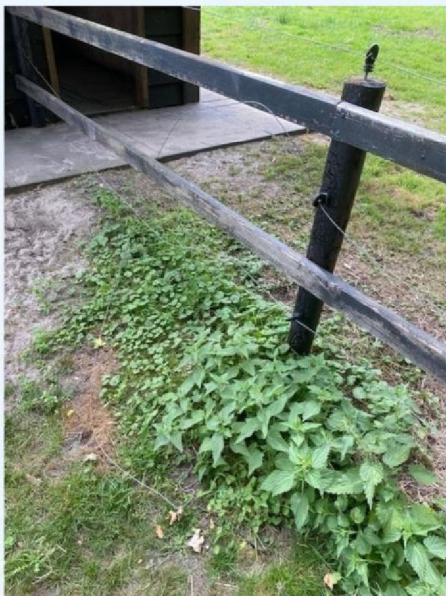
Beschadigde omheining achter de schuur.jpg
