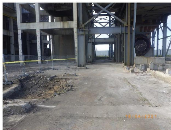
Foto 12: restanten verwijderd uit zone 6, lot ROI.
