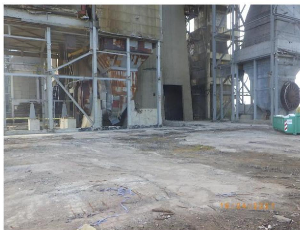
Foto 6: restanten verwijderd uit zone 6, lot ROI.
