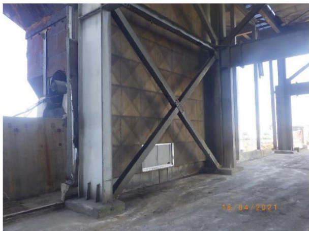
Foto 13: in het inspectie gebied blijft een wand met asbesthoudend stelmateriaal aanwezig.
