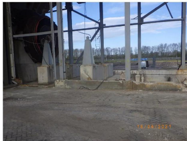
Foto 8: restanten verwijderd uit zone 6, lot ROI.
