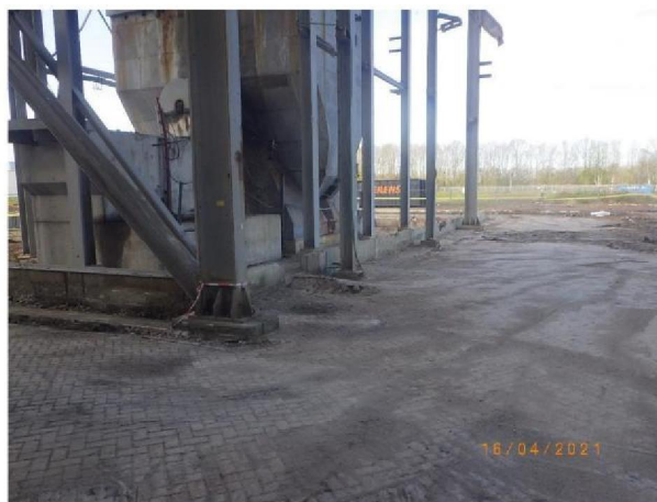
Foto 4: restanten verwijderd uit zone 6, lot ROI.
