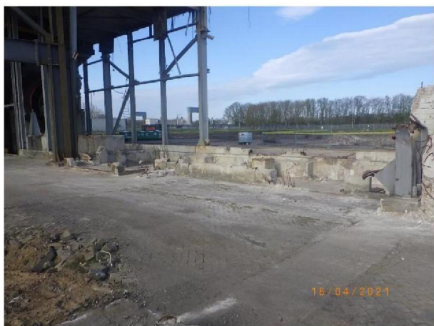
Foto 9: restanten verwijderd uit zone 6, lot ROI.
