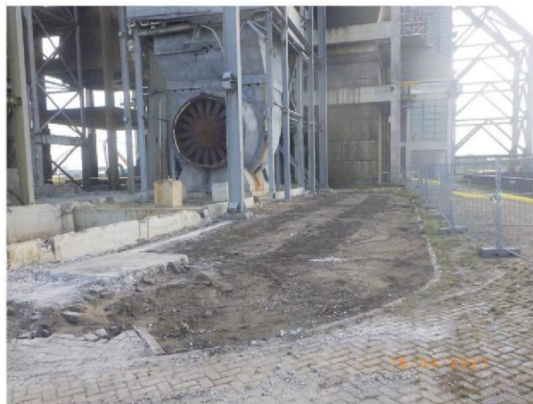
Foto 2: restanten verwijderd uit zone 6, lot ROI.
