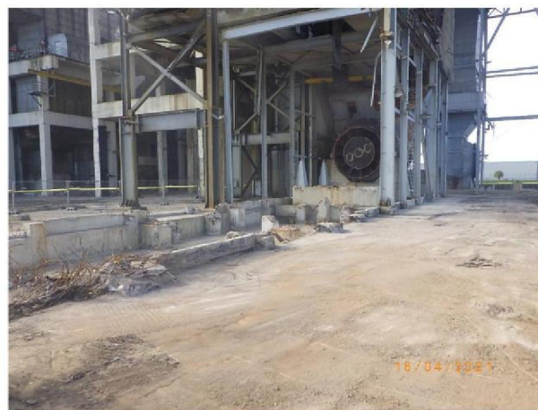
Foto 10: restanten verwijderd uit zone 6, lot ROI.
