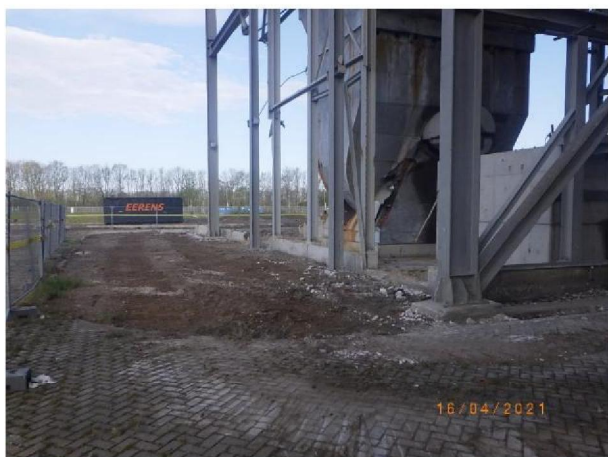
Foto 3: restanten verwijderd uit zone 6, lot ROI.
