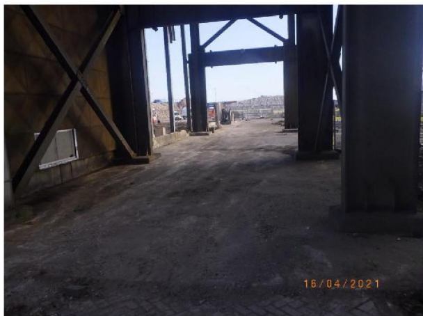
Foto 7: restanten verwijderd uit zone 6, lot ROI.
