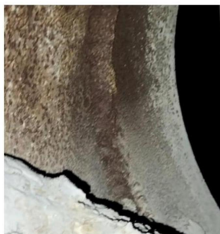
geen koordafdichting aanhechting luik op casing / constructie ronde luiken
