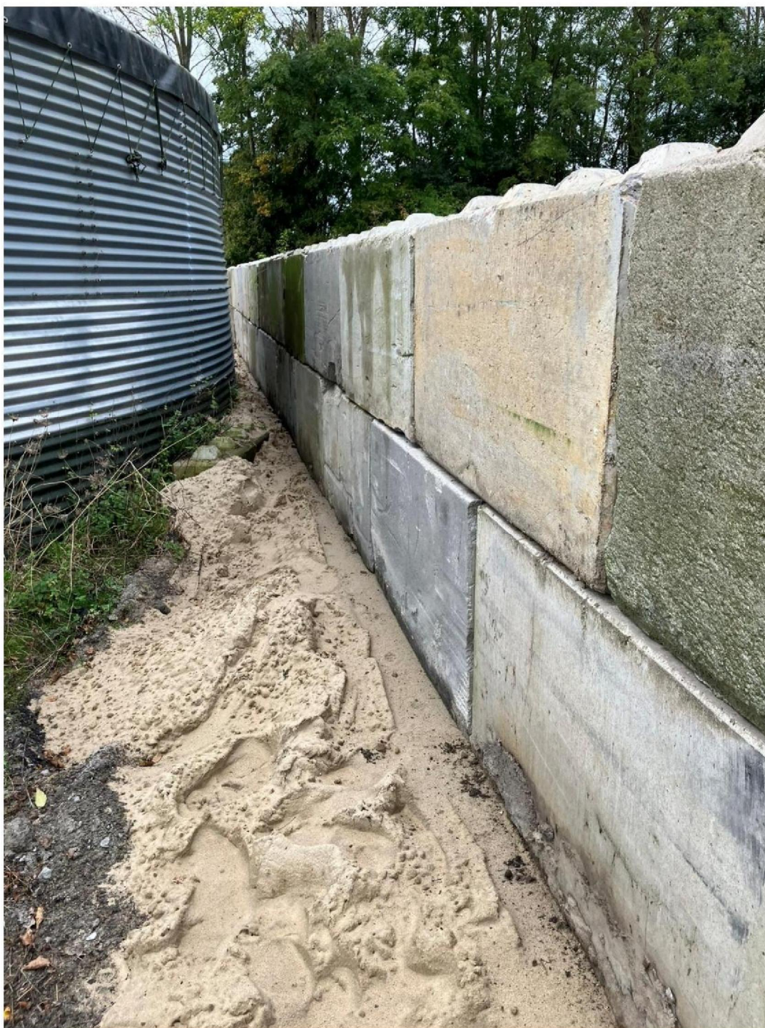
Foto 7: ongebonden en/of niet afgedekte FORZ (bestaande uit bodemas en/of sorteerzeefzand) aan zuidzijde proefveld
