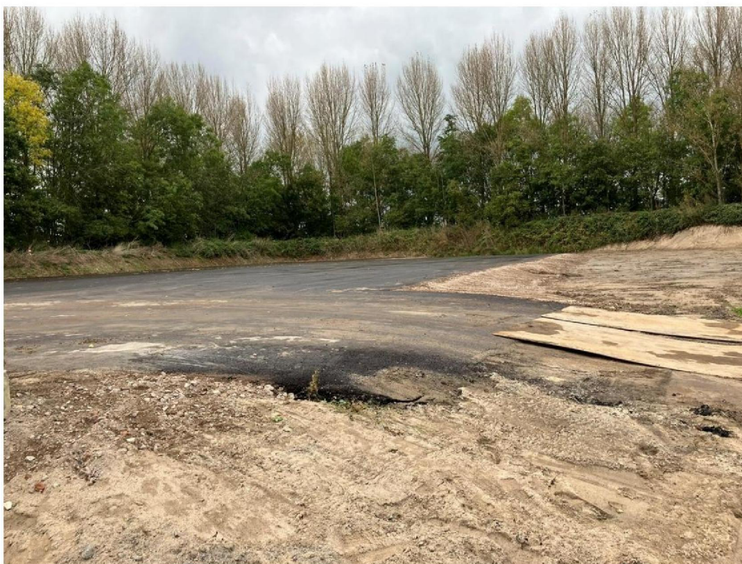
Foto 4: oprit (oostzijde) niet afdoende afgedekt
