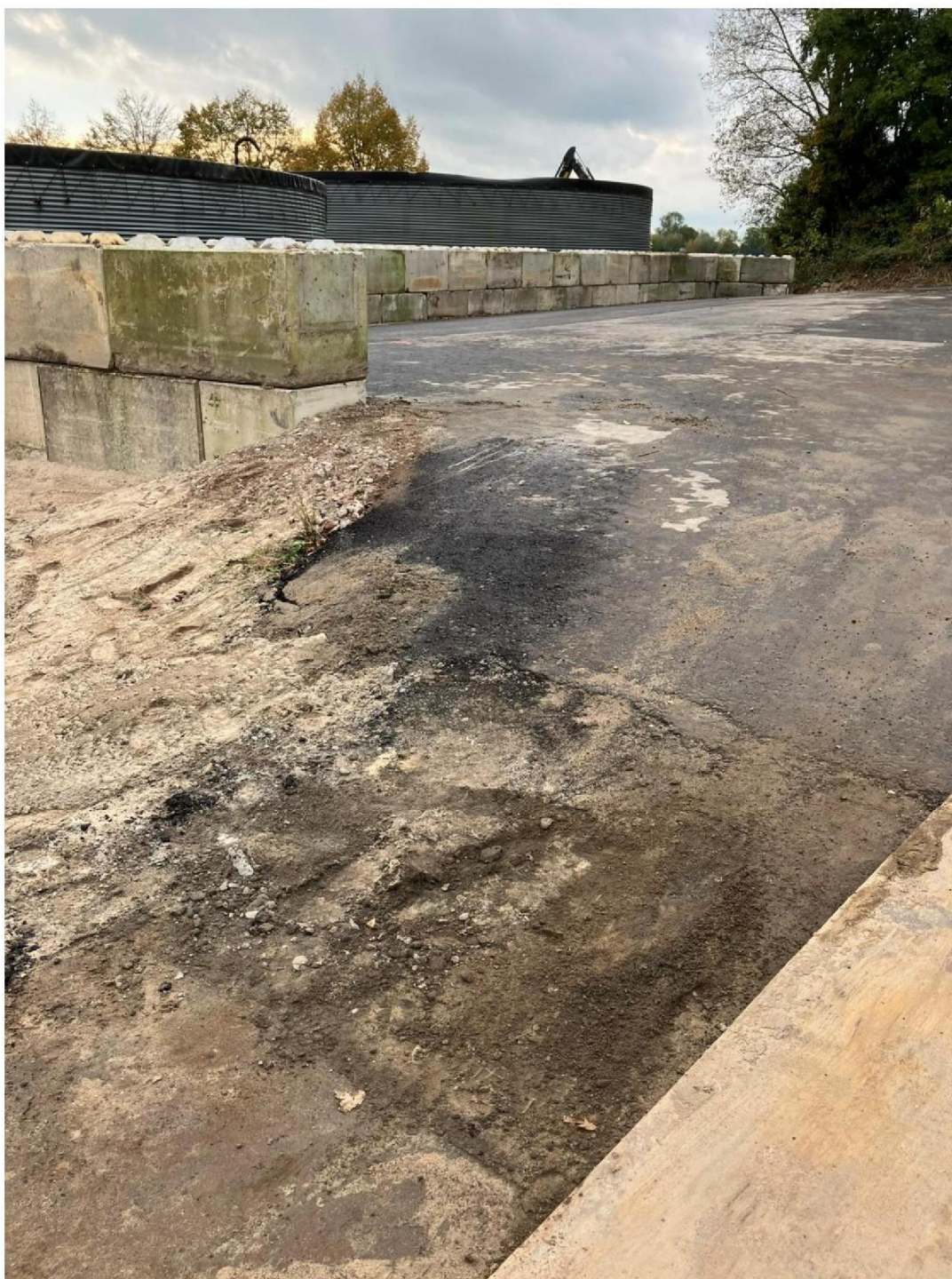
Foto 5: oprit (oostzijde) niet afdoende afgedekt
