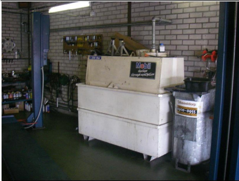
Figuur b2.3 Bovengrondse tank voor afgewerkte olie
