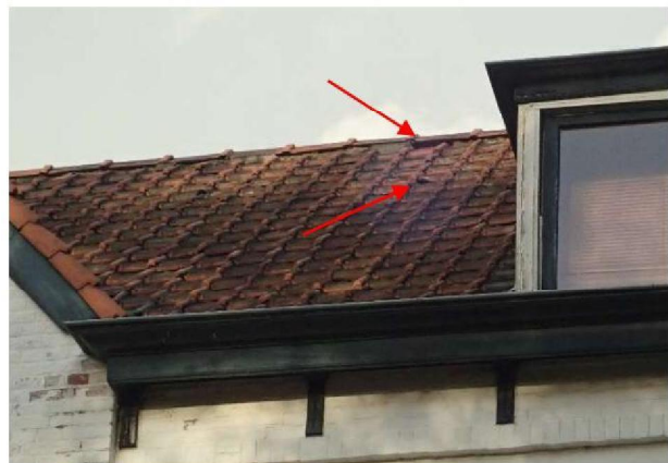
Figuur 4.2: Beschadigde plekken op het dak
