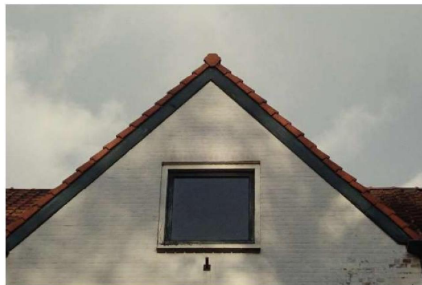
Figuur 4.1: Voorkant van het woonhuis: bij de kantpannen van zo een gevel is er vaak toegang naar het dak
