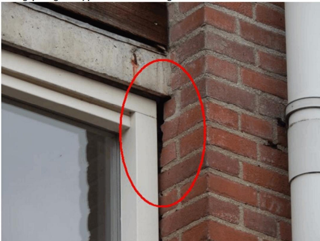
Foto 3 Locaties van aangetroffen verblijfplaatsen binnen het plangebied deel 2 (Bron: Nader onderzoek De Groene Ruimte)
