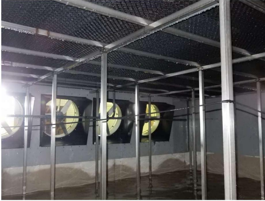
Foto plaatsing leiding met full cone nozzles voor een rij ventilatoren, ca. 15° omlaag gericht.
